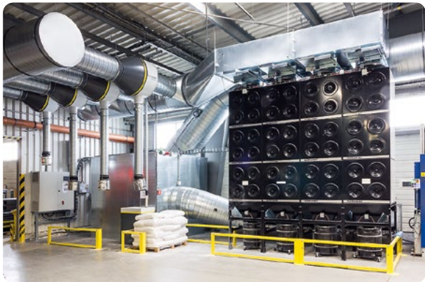
odsávací a filtrační jednotka svařovny
