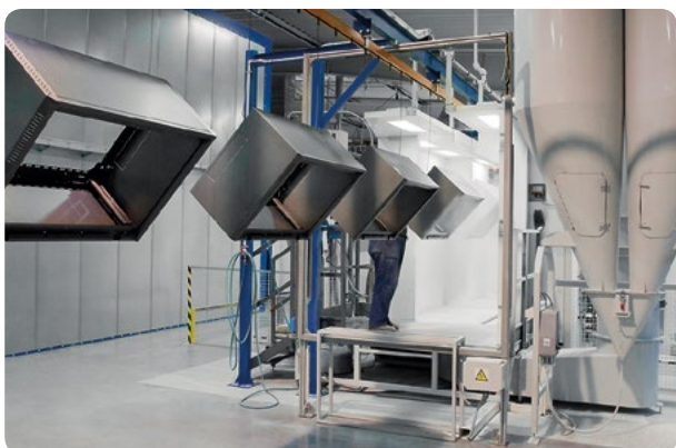
automatizovaný stříkací box práškové lakovny
