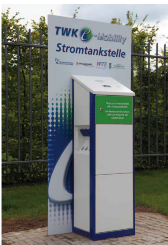
Dodavatel energie ECOLECTRA 330 SCHUKO, CEE 32A RFID se skupinovým oprávněním Stanoviště: Zahradnická výstava Kaiserslautern
