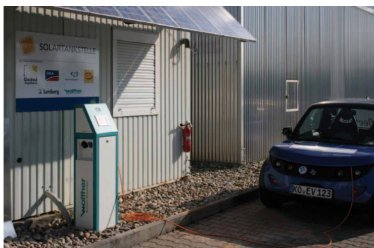
Projekt vysokoškolského svazu „Komplexní využití obnovitelných zdrojů“ ECOLECTRA 320 SCHUKO, CEE 16/32A, 7pólový typ 2 RFID Stanoviště: Bingen, solární nabíjecí stanice
