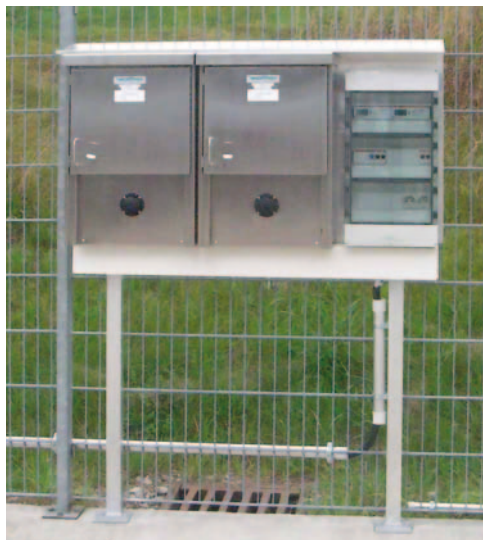
Rozváděč z ušlechtilé oceli s nabíjecími zásuvkami
