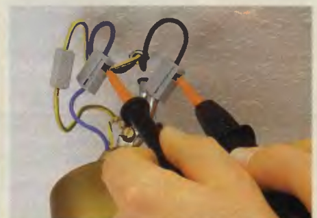
Prüfen in separater Prüfföffnung
