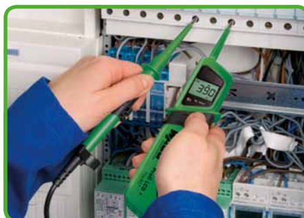
Zkoušení napětí ve skříňovém rozvaděči
