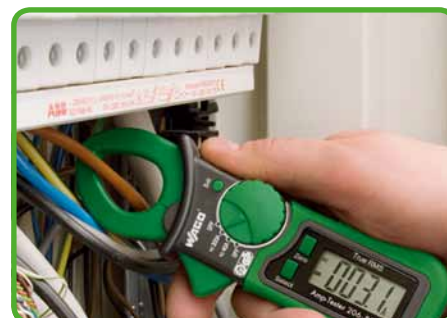
Měření proudu ve skříňovém rozvaděči
