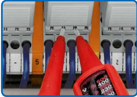
Kontrola funkčnosti na kontaktech pro dotykové zkoušení chráněných proti nebezpečnému dotyku
