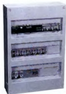
Rozváděč Pragma s odpínačem Interpact
