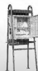
Stavební rozvaděče s měřením str. 100
