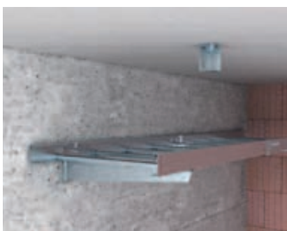
Upevnění kabelového žebříku Upevnění kabelového žebříku LG60VS/F k výložníkům pomocí přichytky LKS40.
