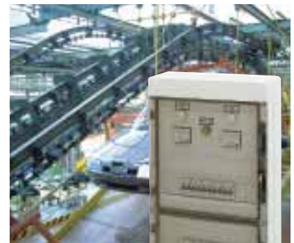
Rozvaděč kombinovaný s přístroji, indikátory, ovládacími prvky a jističi. Ovládání, měření a ochrana elektrických zařízení s přístupem vyhrazeným osobám autorizovaným.
