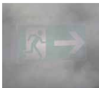
Špatně osvětlená bezpečnostní značka
